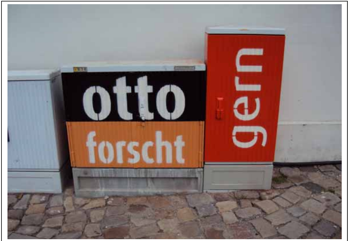
Bild 1: Steuerungsschrank des Tiefbauamtes für Ampelanlage - Jakobstraße / Altes Rathaus
