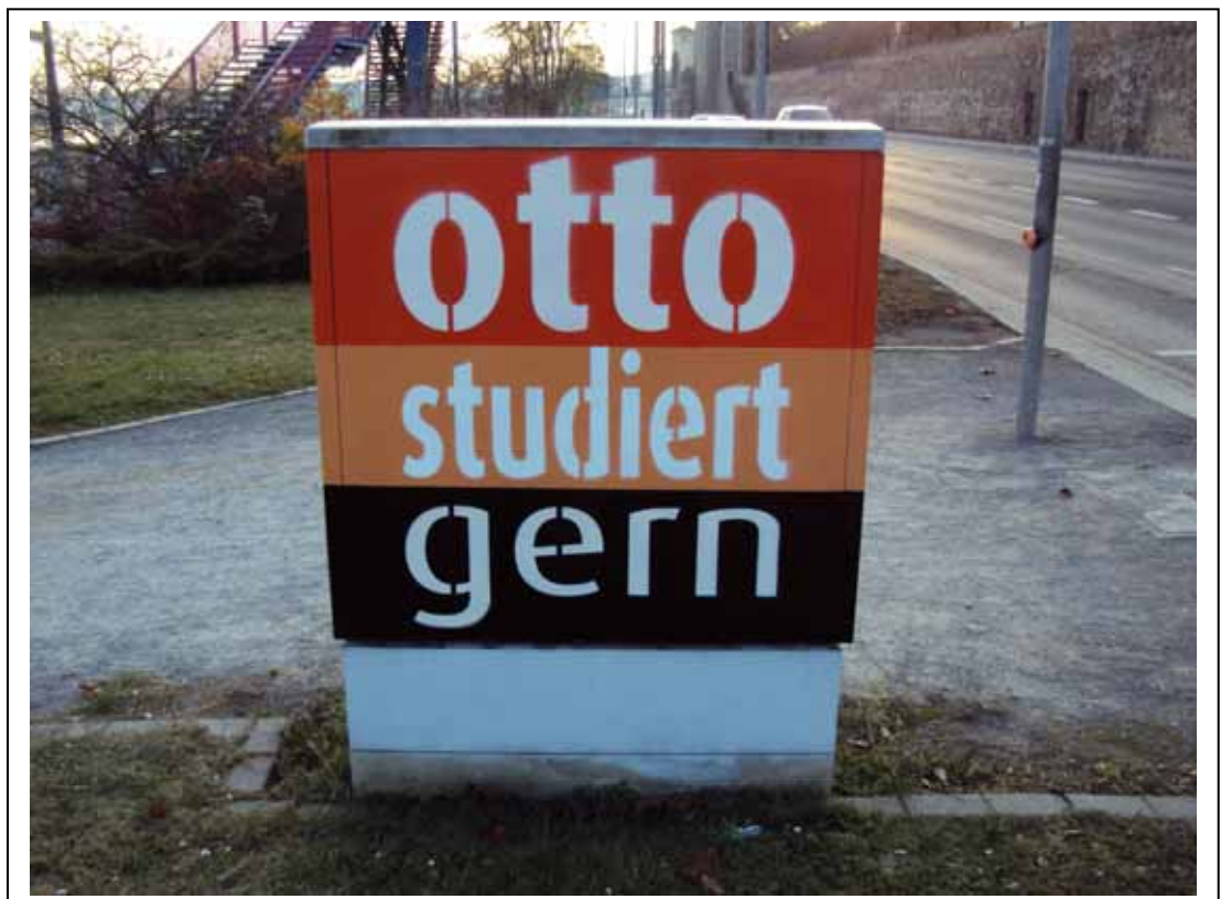
Bild 2: Steuerungsschrank des Tiefbauamtes für Ampelanlage - Schleiufer
