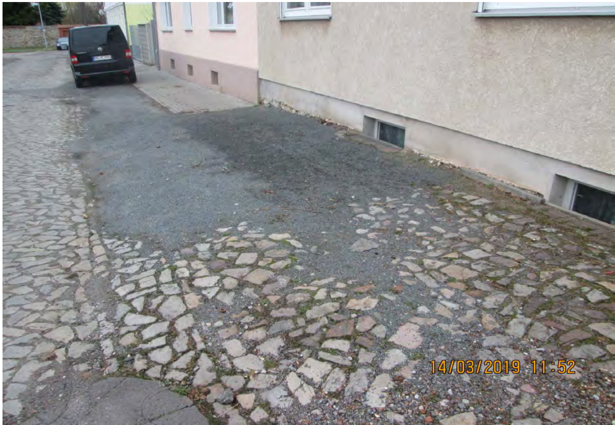
Unterschiedliche Oberflächenbefestigung der Gehwege, teilweise unbefestigt
