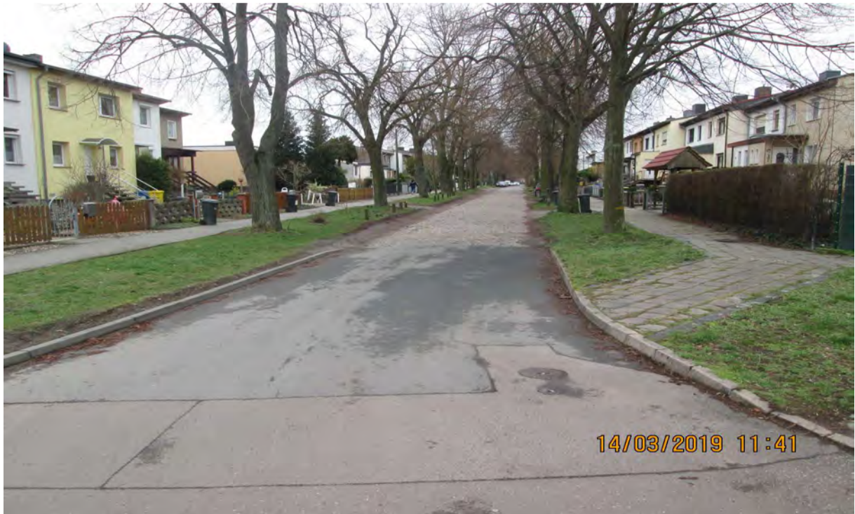
Fahrbahn mit Großpflaster und überbauter Asphaltdecke weist leichte Unebenheiten auf, keine Bordanlage nach Einmündung in den Stadtweg vorhanden.
