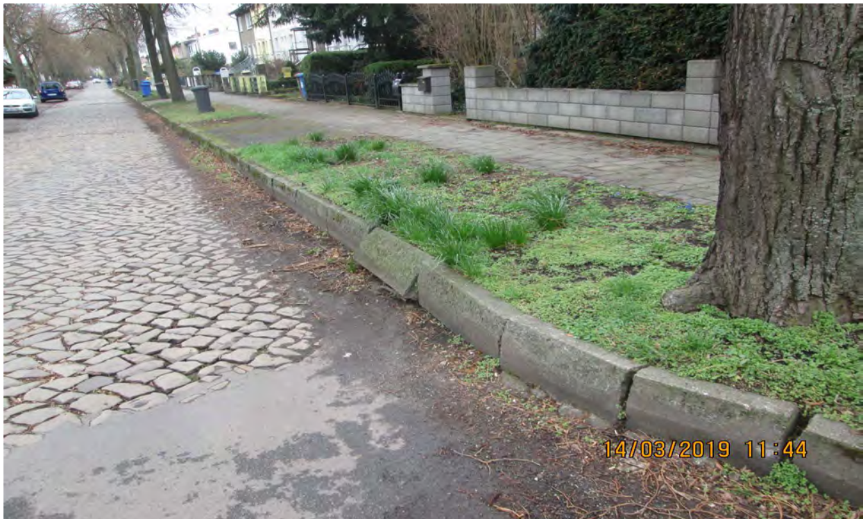
Abschnittweise lose Bordanlage vorhanden, welche die Verkehrssicherheit beeinträchtigen.
