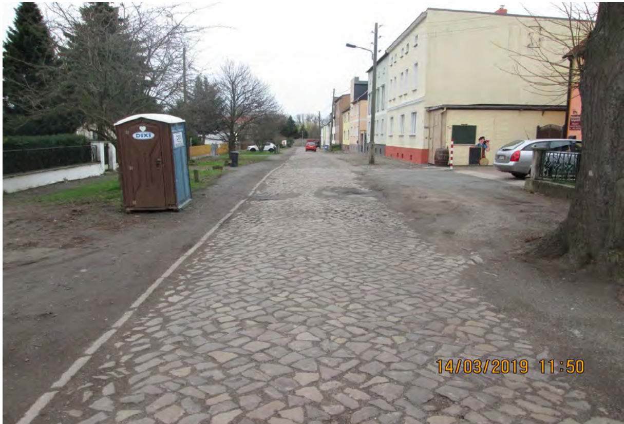
Seitenbereiche sind unbefestigt. Die Beleuchtungsanlage ist zu erneuern.
