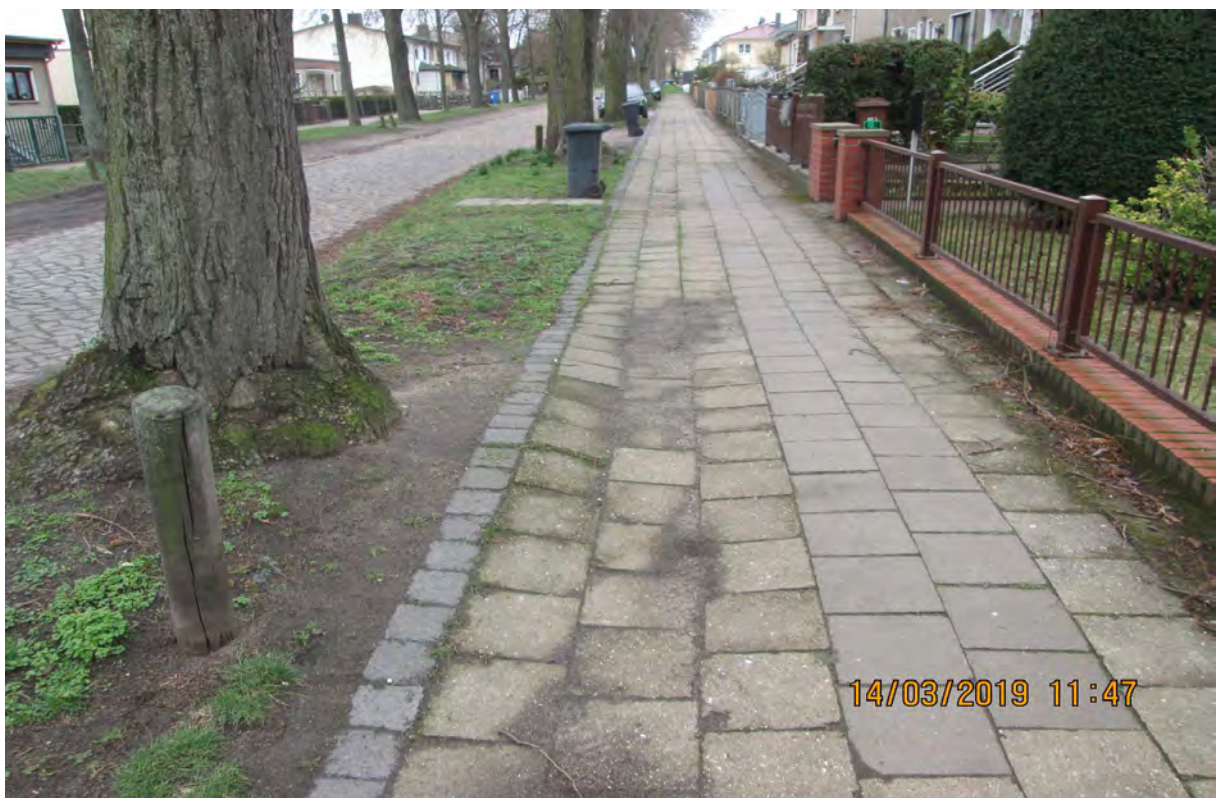
Gehwege sowie Straße geprägt durch starke Unebenheiten aufgrund Wurzeltrieb.
