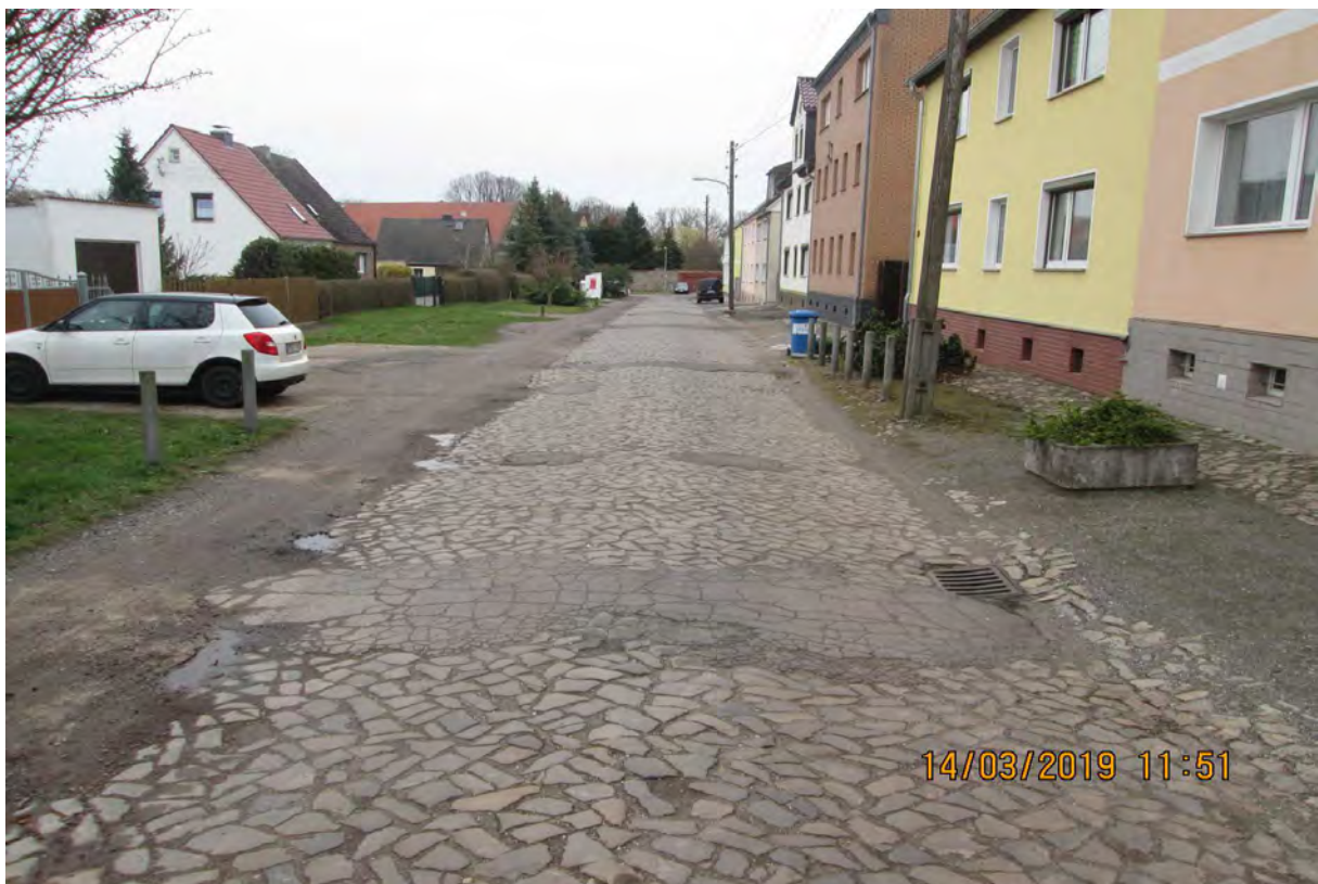
Fehlende Entwässerungseinrichtungen bedingen das Bilden großer Pfützen in der Fahrbahn bis hin zu Überschwemmungen der Seitenbereiche.
