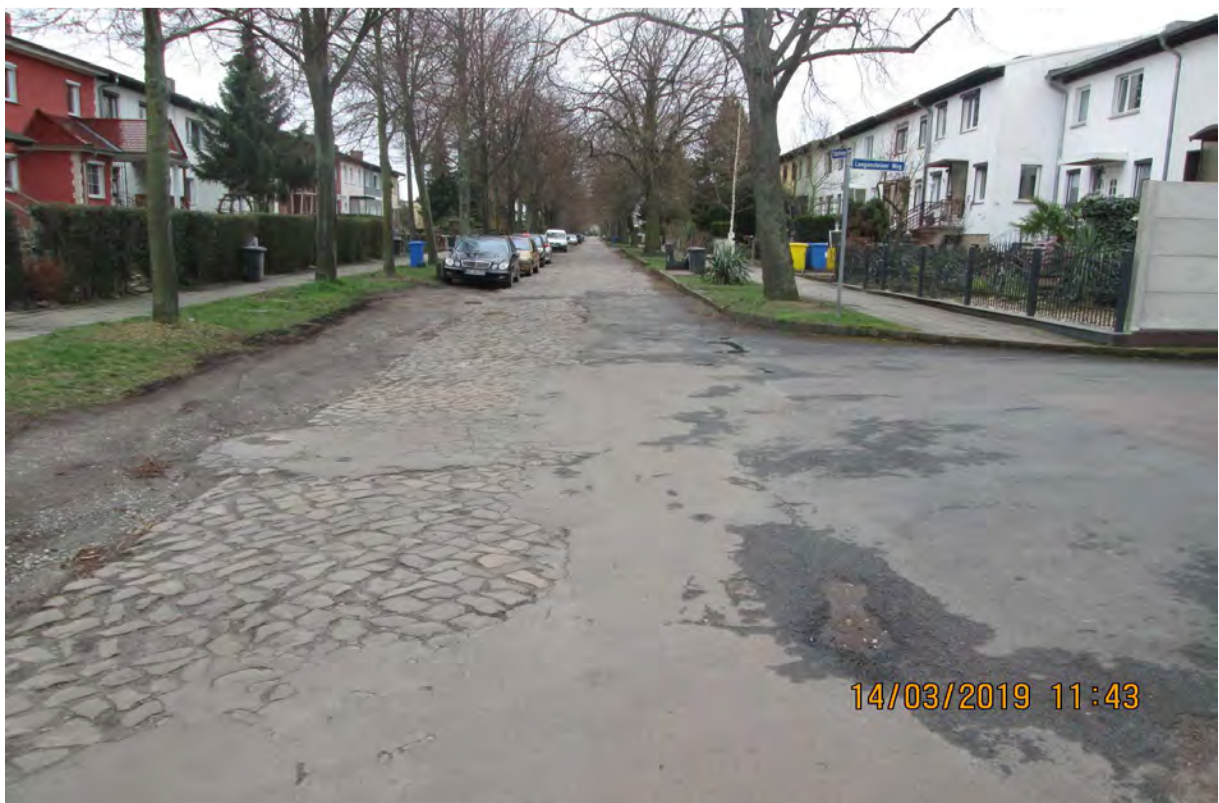
Fahrbahn bestehend aus Asphaltdeckschicht auf Großpflaster mit sichtbaren Straßenschäden.
