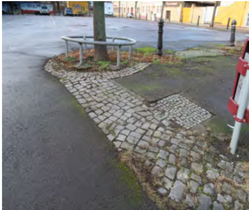
Rissiger Asphalt, stark unebene Oberflächen
