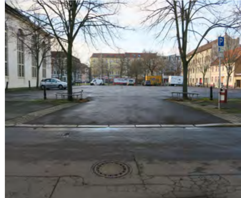
Durch das unregelmäßige Höhenniveau im Bereich der Parkplätze fehlt eine gleichmäßige, großzügige Veranstaltungsfläche. Barrierefreier Zugang beeinträchtigt
