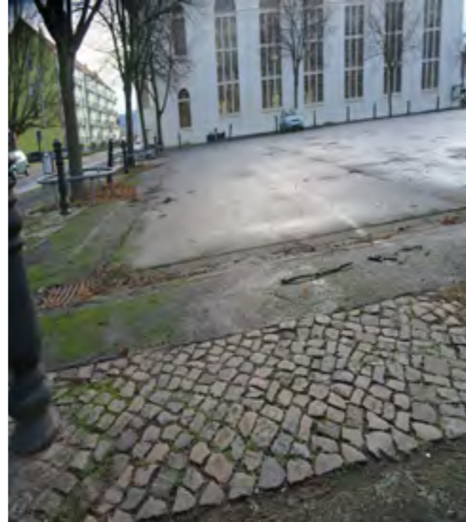
Hervorstehende Belagskanten, desolater Zustand im Traufbereich der Bäume
