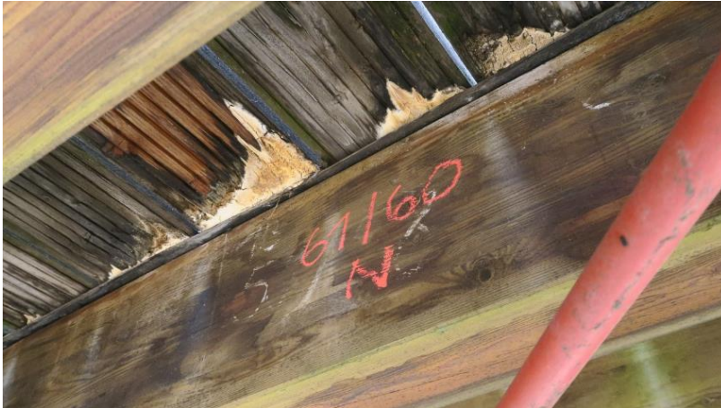
Abb. 3.2: Pilzbefall an Belagsbohlen und Längsträgern auf Höhe A 40
