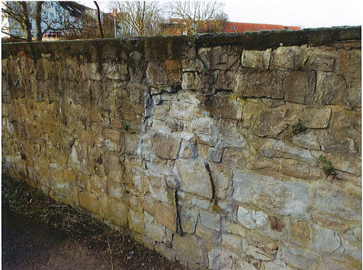
Mauerschaden nach Reparatur
